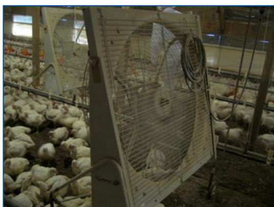
Figura 100: Ventiladores de circulación en una nave de ventilación natural.
