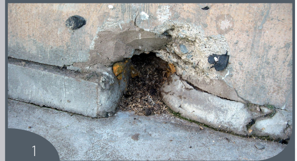
1 Madrigueras en los cimientos de la nave.
