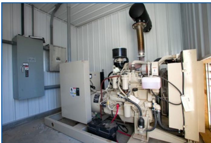
Figura 97: Exemplo de gerador reserva.
